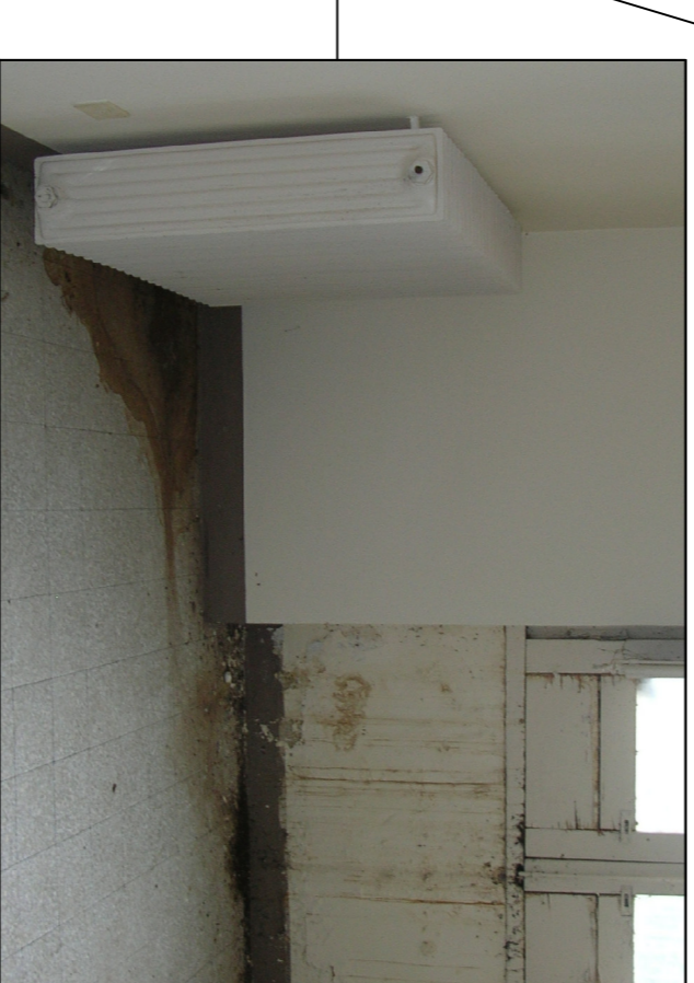
FIG. 07 INFISSI E IMPIANTI DA ADEGUARE
