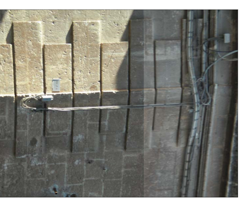
Foto 5 - Localizzazione cassetta e cavo di alimentazione
